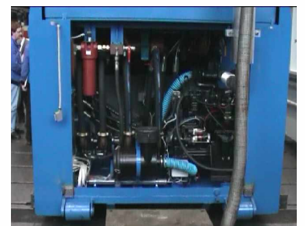
Fig. 7: Vue de l'arrière de la machine, capot de protection ouvert, montrant le moteur diesel John-Deere à refroidissement à eau.
